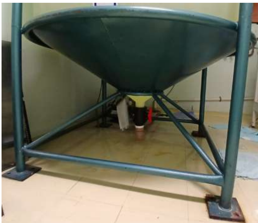
ANEXO 04 - FOTOS DOS TANQUE EXISTENTE
